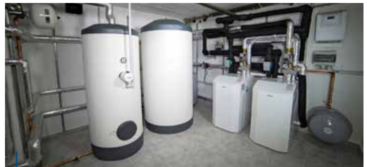
Mit den Wärmepumpen zieht bei Familie Scharrer die Zukunftssicherheit ein.
